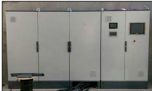
EXEMPLE DE BOUTON POUSSOIR D'ARRET D'URGENCE SUR ARMOIRE ELECTRIQUE
