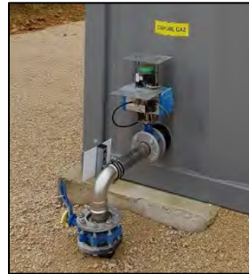
EXEMPLE DE VANNE AUTOMATIQUE ET MANUELLE SUR LA CONDUITE DE BIOGAZ
