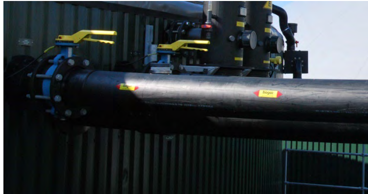
CANALISATION DE TRANSPORT DE BIOGAZ
