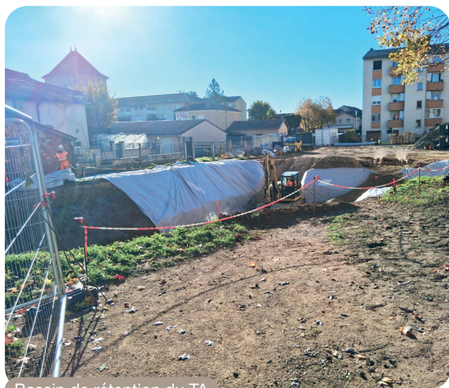
Bassin de rétention du TA
