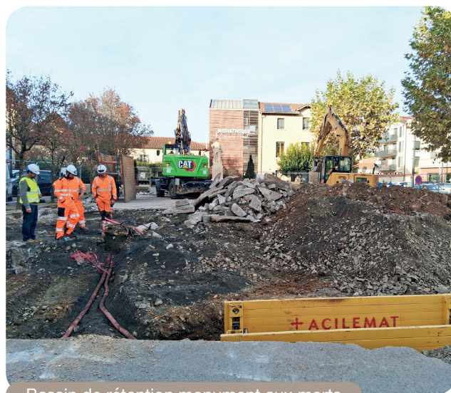
Bassin de rétention monument aux morts
